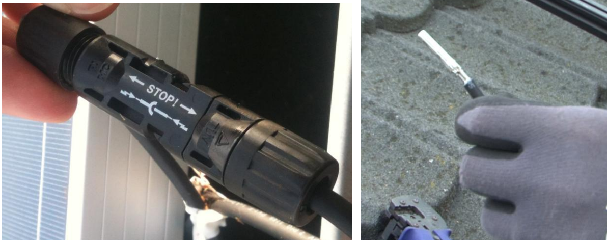
Til venstre ses et eksempel på et af de to stik, som typisk sidder gemt under de enkelte solcellepaneler. Til højre ses en blottet ledning, som risikerer at ligge på taget, hvis ledninger klippes.
