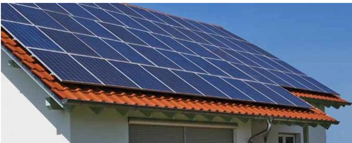
Et anlæg installeret på et parcelhus.
